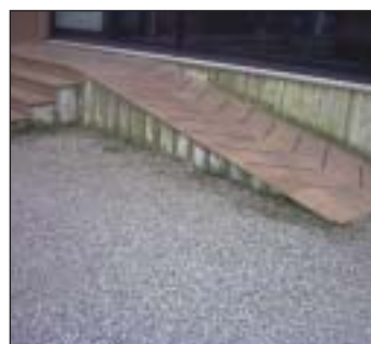
A1-9 Rampa con pendenza eccessiva, priva di parapetto e variazione cromatica
