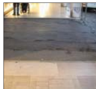
B1-3,4 Percorso pedonale con superficie sconnessa e sdruciolevole
