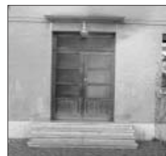
A1-12, 13 Assenza di segnaletica informativa, citofono e campanello
