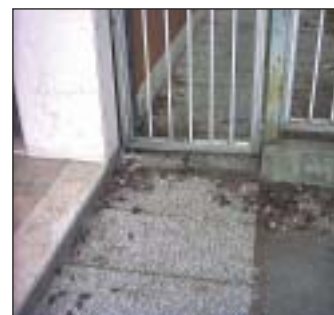
A1-5 Pavimentazione sconnessa in corrispondenza dell'accesso
