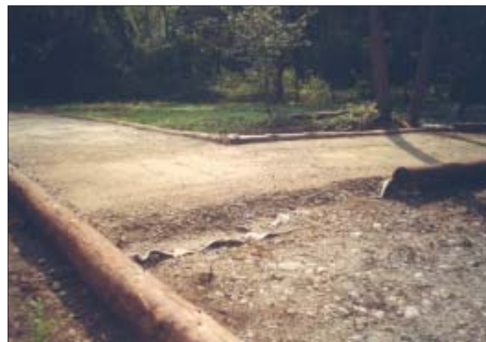
Foto n. 40 - Bosco delle Fontane a Cison del Grappa (VI), pavimentazione in costruzione di un percorso accessibile.
