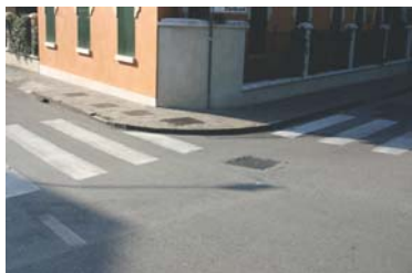
Attraversamenti pedonali privi di rampe
