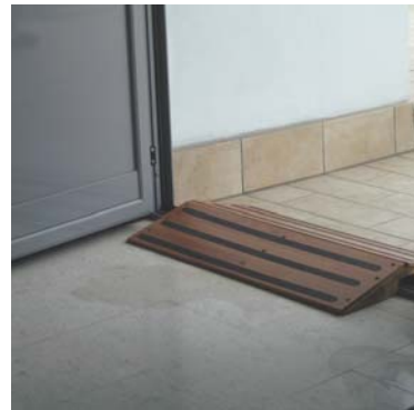
Particolare di una doppia rampa per superare la battuta di un serramento in alluminio
