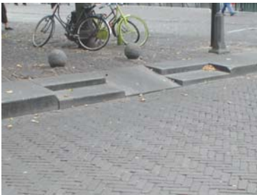
Abbinamento corretto tra rampa e scalini
