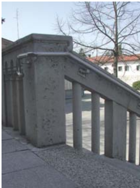
Corrimano correttamente prolungato 30 cm oltre l'ultimo gradino
