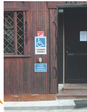
Segnaletica incongruente e marciapiede troppo stretto
