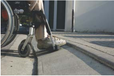
Esempio non corretto di rampa di raccordo
